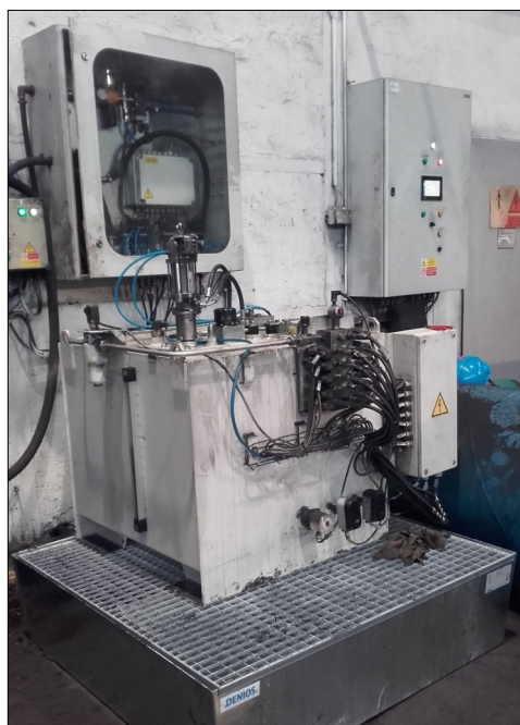
Čerpací stanice, skříň s pneumatickými prvky (nahore), elektroovládání (vpravo)
