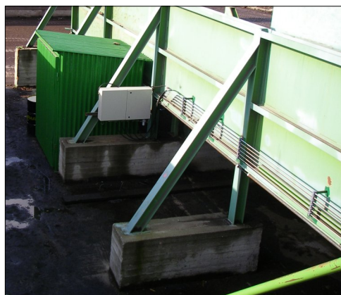
Přístřešek s čerpadlem, skříňka s pneumatickými a hydraulickými prvky, hlavní rozvody
