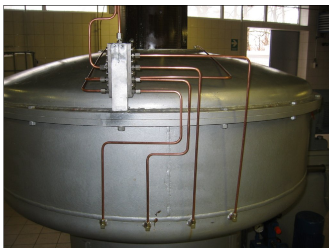
Pohled na zcezovací tank s jedním ze sekundárních progresivních rozdělovačů
