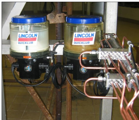
Čerpadla P203 s různými druhy tuků v zásobnících a primární progresivní rozdělovače
