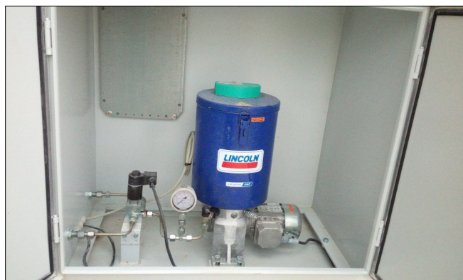
Čerpadlo s příslušenstvím a elmag. ventilem v rozváděčové skříni
